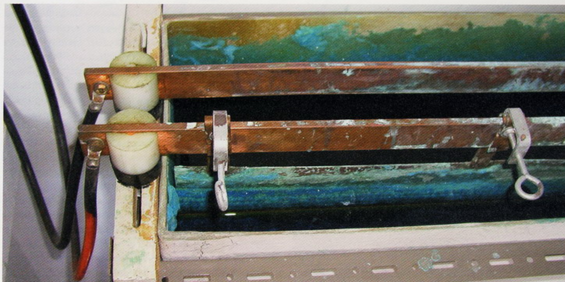
Sistema vertical de cubeta, donde se aprecian las conexiones al anodo y el catodo y su forma de aislamiento
